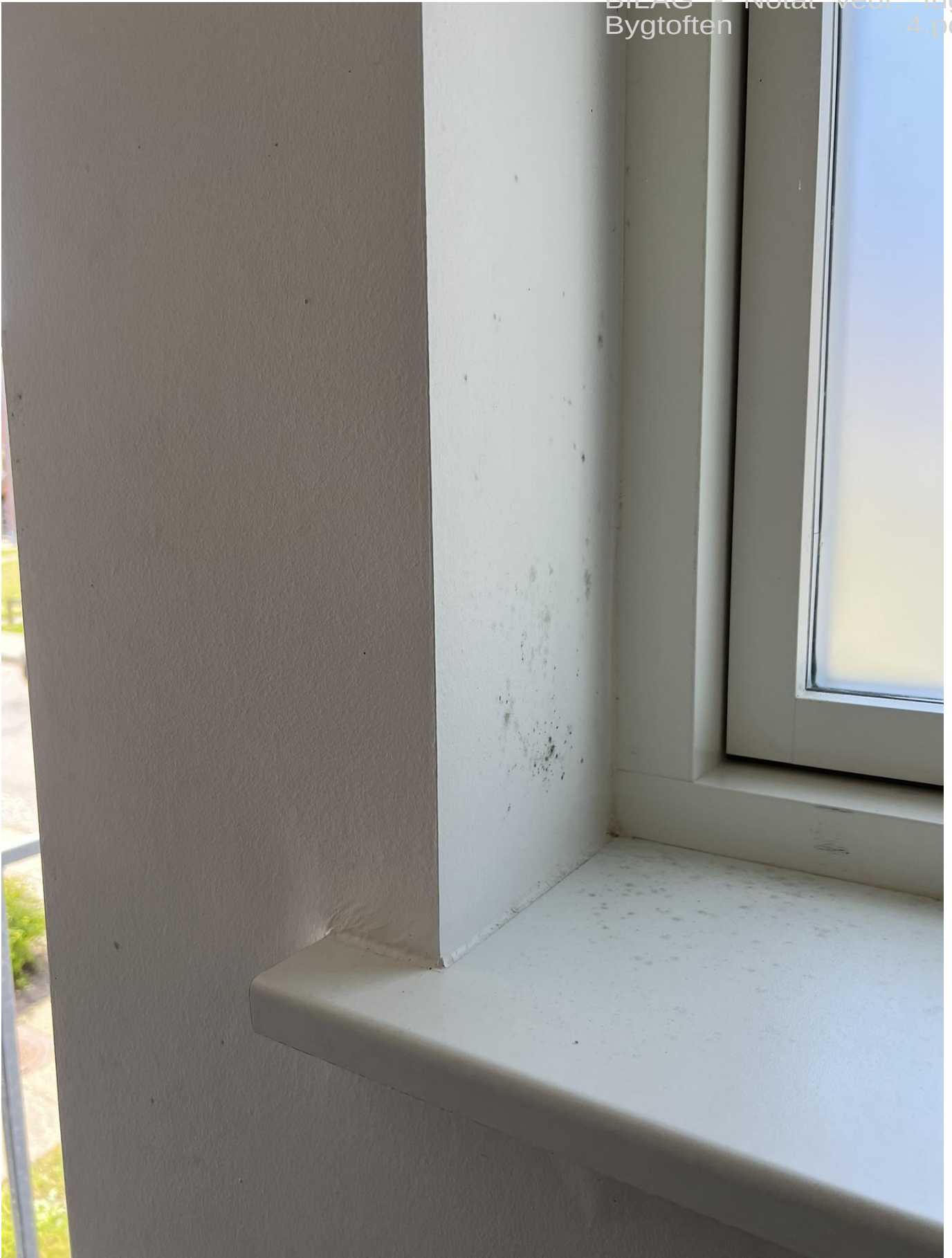
Foto 5 – viser skimmel i vindueslysning.
