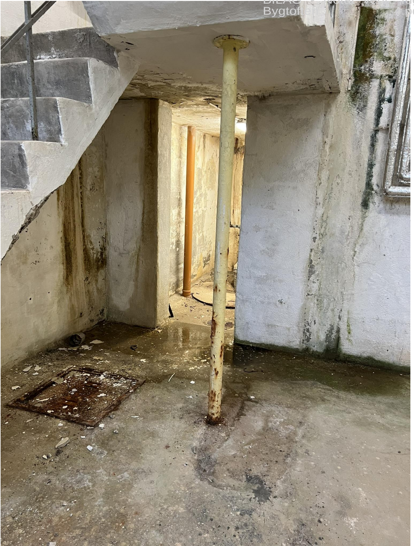
Foto 6 – viser blank vand på gulvet i kælderen
