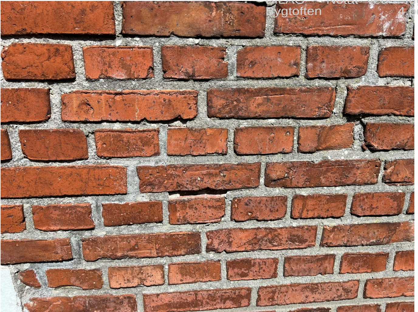
Foto 5 – dårlige murværksfuger på gavl.
