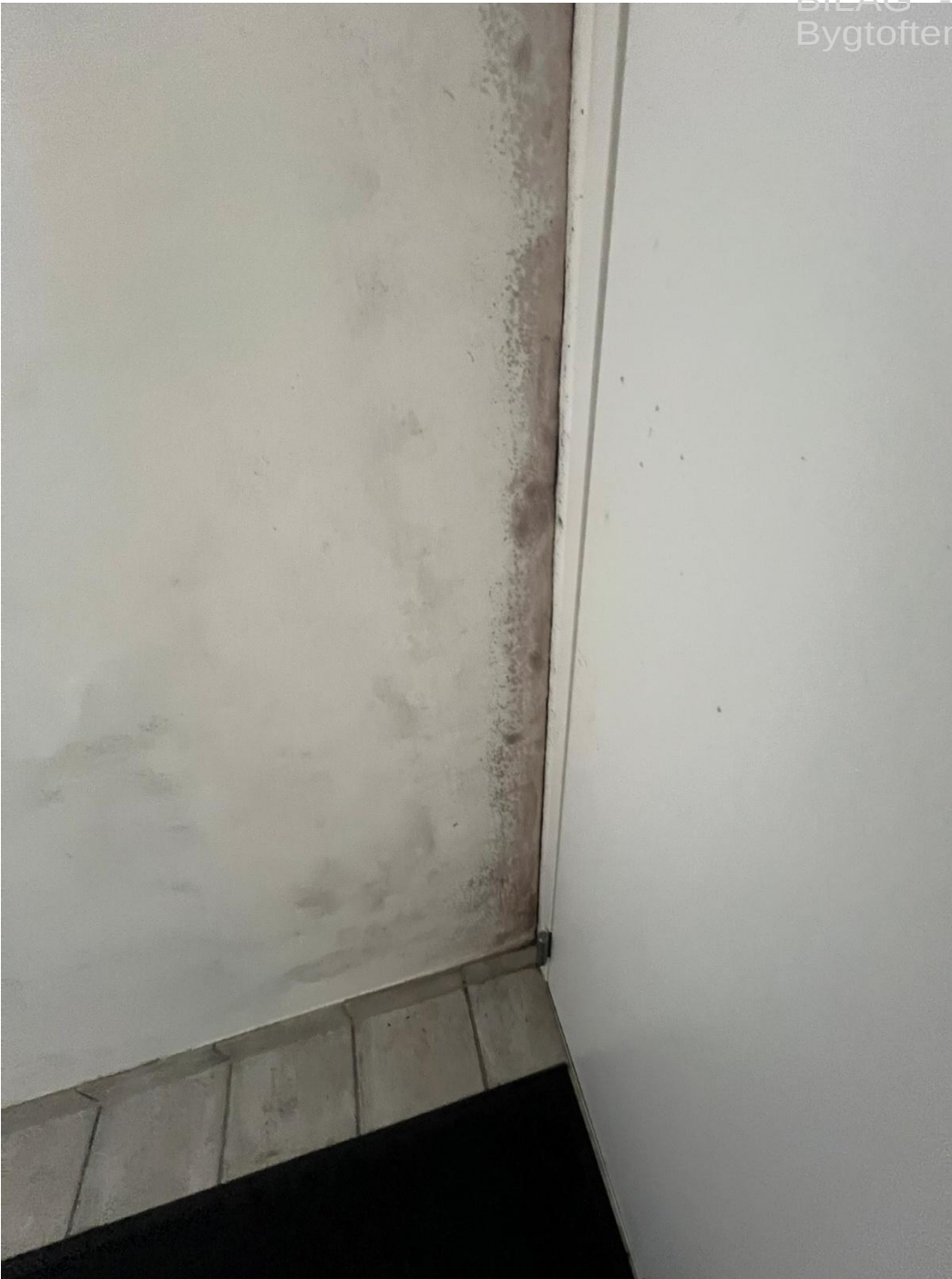
Foto 4 – skimmel på gavlvæg ved yderdør.
